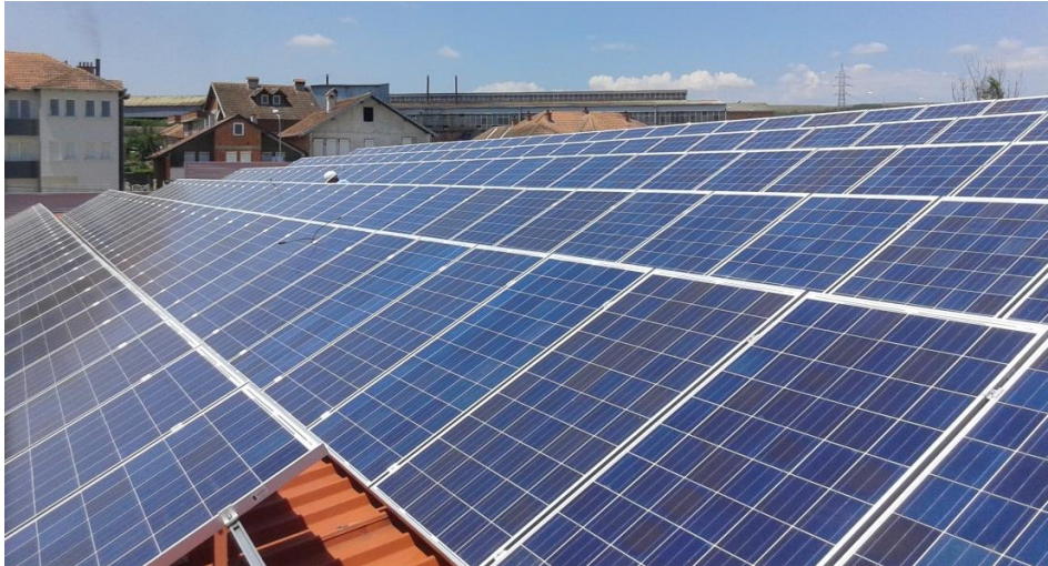
Fig. 8.1 Panelet fotovoltaike të montuara në kulm të Qumështores “DRENA”
