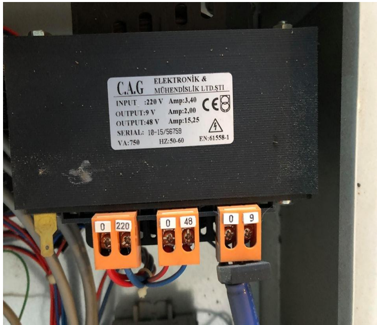
Figura 3.38. Shëndruesi i tensionit (trafo)
