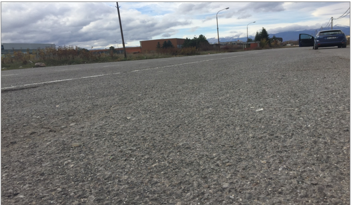
Figura 6.3. Vrazhdësia e asfaltit në lokacionin e shfrytëzuar (rruga me asfalt të vjetër)
