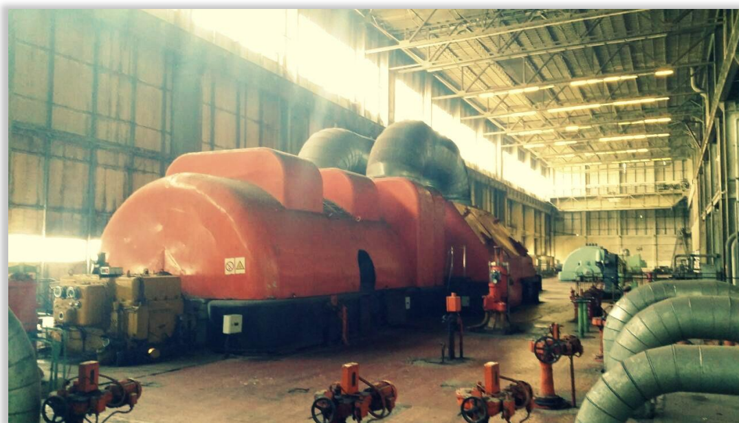
Fig. 3.4. Pamje nga turbina e bllokut A3 të termocentralit Kosova A
