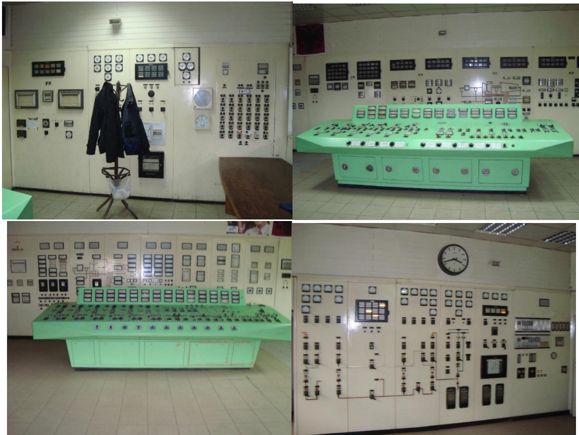
Fig.2.8. Instrumentet matëse dhe manipuluese elektrike, të kaldajës dhe turbo-gjeneratorit për bllokun A1.
