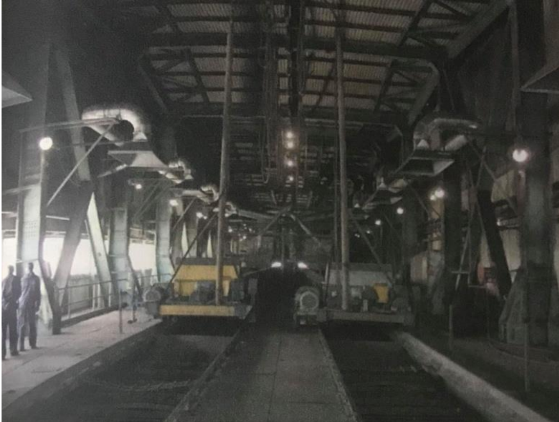
Figura 7. 4 Karrocat dhe shiritat reversibil në kuotën 51 m për mbushjen e bunkerëve të qymyrit në të dy anët e tyre.
