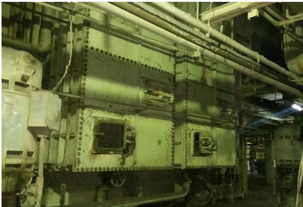
Fig.2.8. Kondensatori i bllokut A2.
