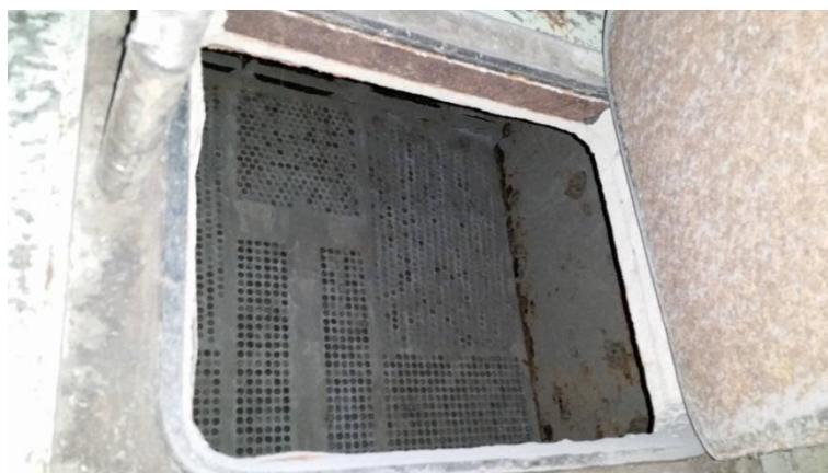
Fig.2.9. Radhitja e tubave të ujit ftohës në kondensator, jashtë të cilave rrymon avulli për kondensim.
