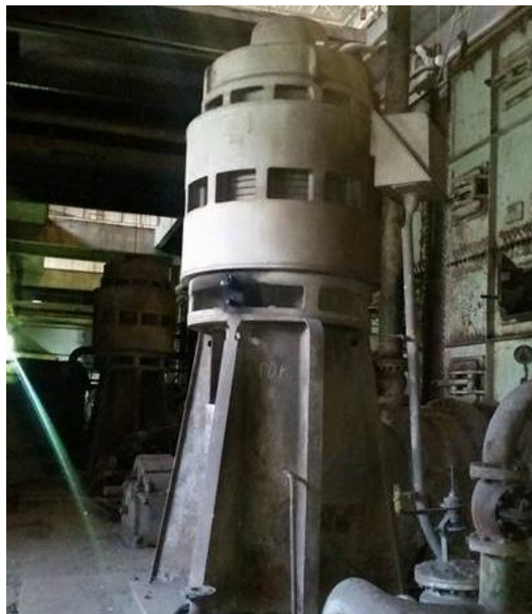
Fig.2.15. Pompat qarkulluese të bllokut A2 të cilat janë gjithsej dy të tipit: 48HH – GPM-45000 HAED – 75FT.
