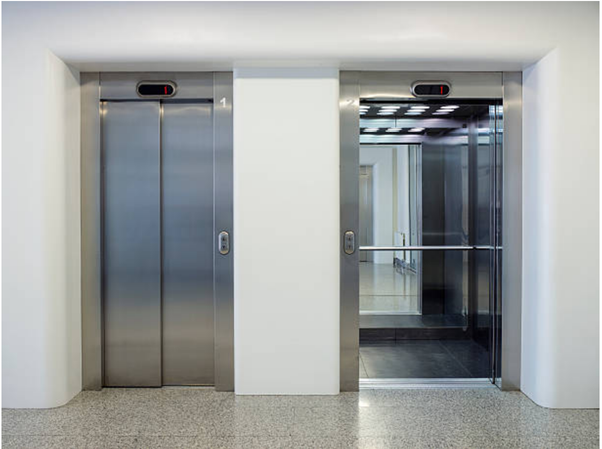
Fig. 3.3.5 .Dyert e pusores te ashensorët elektrik.
