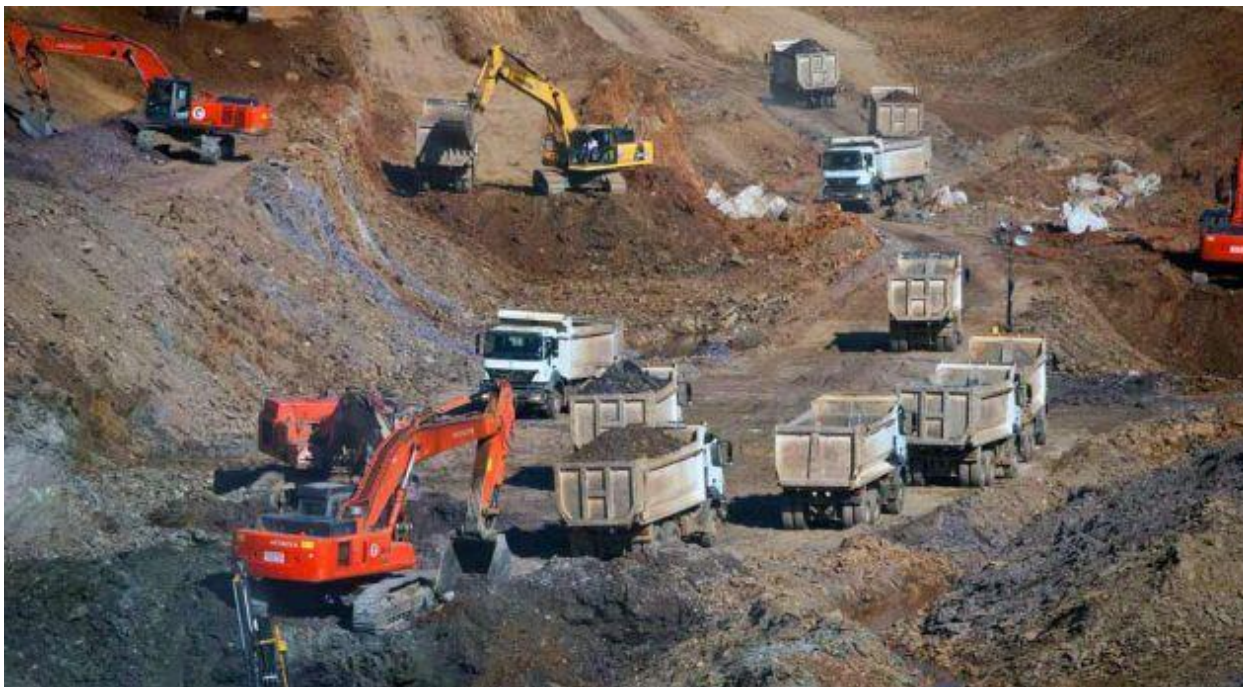
Figura 4.8 Bechtel-Enka,gërmimet e pa kontrolluara mund të rrezikojnë shëndetin dhe sigurinë e të punësuarve.
