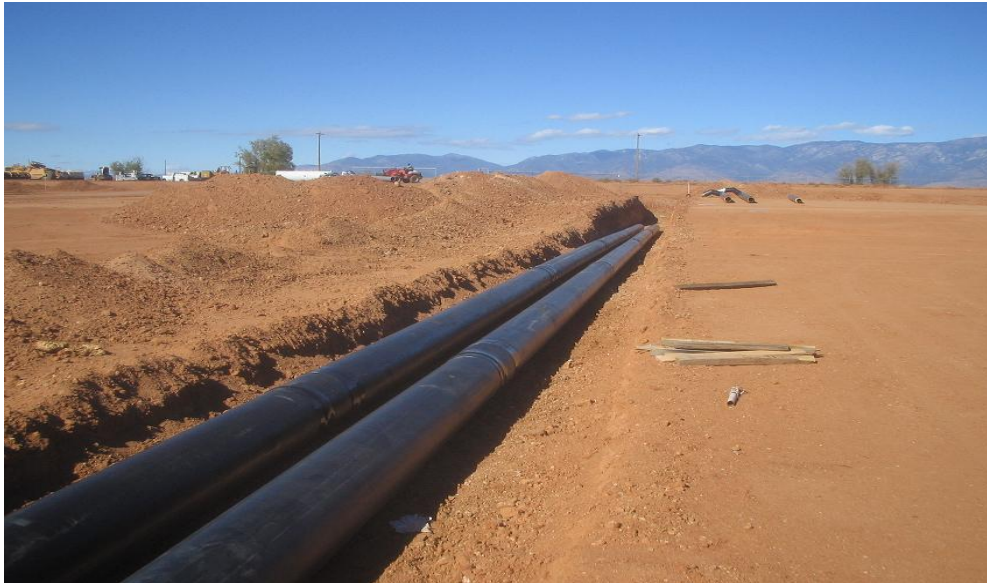
Fig.8.19. Tubat e çelikut të paraizoluar nën nivelin e tokës
