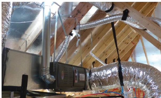
Fig. 2.6. Kanal fleksibil i montuar në objekt
