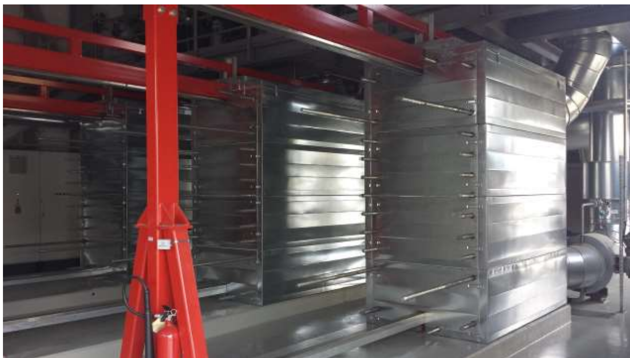
Figura 5.29. Nënstacioni termik me tre këmbyes të nxehtësisë me pllaka, me kapacitet 50 kW për secilin prej tyre të vendosur në ndërmarrjen “Termokos”.
