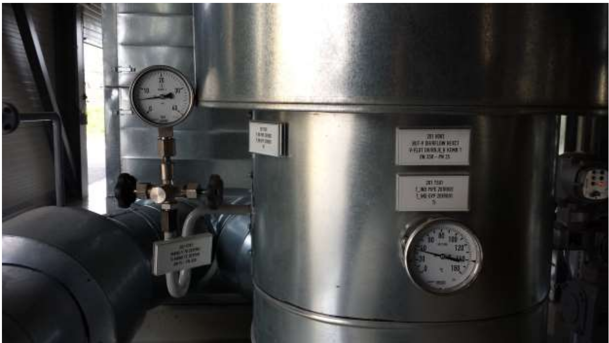
Figura 5.30. Nënstacioni termik i “Termokosit”: Këmbyesi i nxehtësisë, etiketa e këmbyesit të nxehtësisë, pompat e qarkullimit të ujit dhe matësit e regjimit të punës së këmbyesit.
